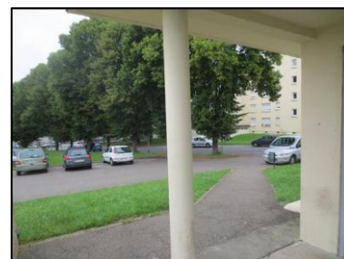
Photo N° 1090 AMIANTE CIMENT -- HALL EXTERIEUR Poteaux Coffrage perdu
